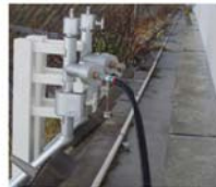
重油移送配管
