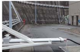
軽油移送配管
