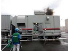
空冷式非常用発電装置
