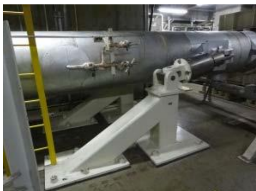
図①-4-3 耐震性向上のため設置したサポート金具（配管）
