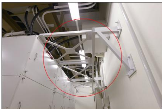
図①-4-2 耐震性向上のため設置したサポート金具（電源盤）
