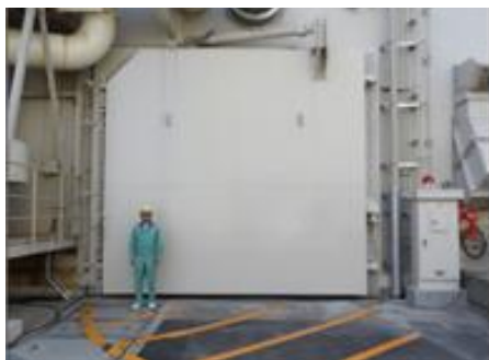
水密扉（非常用ディーゼル発電機室シャッター開口部）
