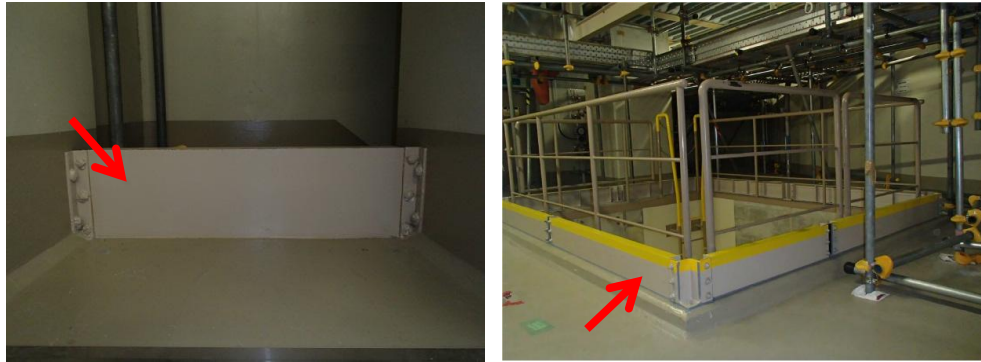
内部溢水により重要機器の水没を防ぐため、建物内の重要機器の部屋入口などに堰を設置
