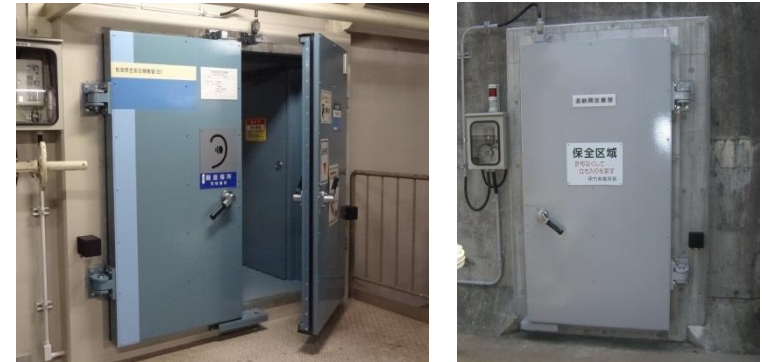
屋外タンクからの溢水による重要施設を配備する部屋の浸水を防ぐため、水密扉にて対応（申請時は自主設置設備）
