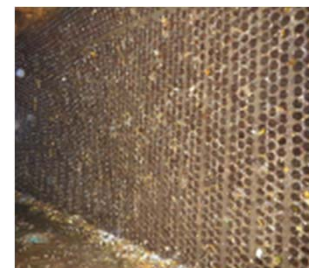
復水器(点検前)
