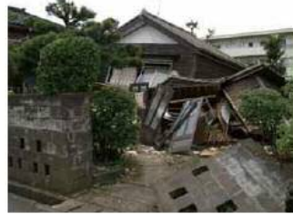
【全壊】一見して住家全部が倒壊
