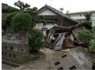
【全壊】一見して住家全部が倒壊
