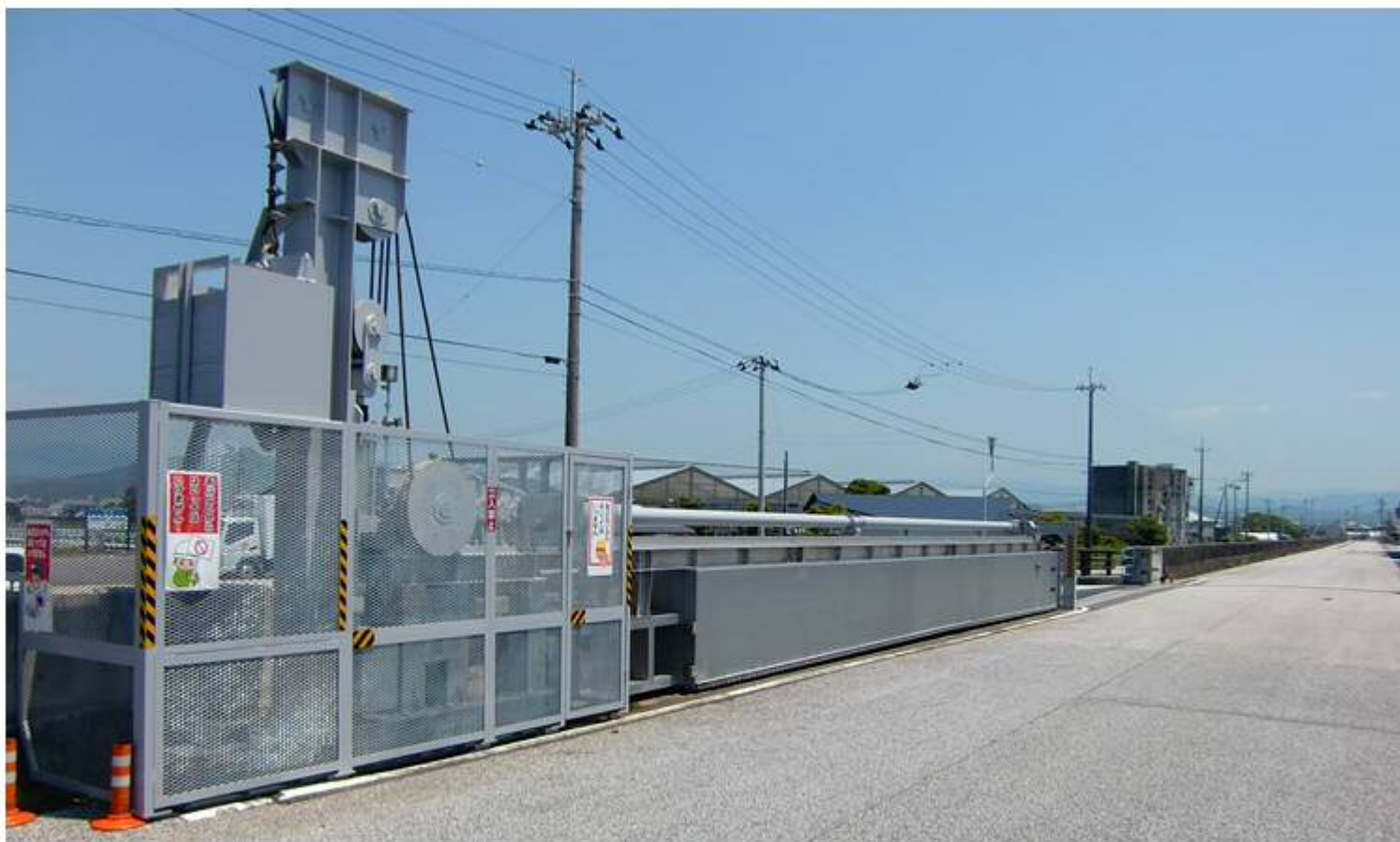
香南市吉川漁港ゲート陸閘No.2ゲート 平成27年4月に実施設置し、作動確認済
