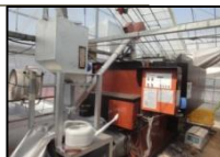
木質バイオマスボイラー
