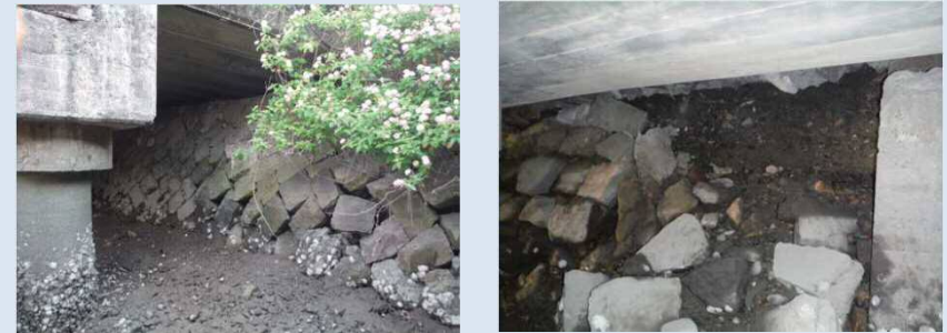
駐車場下区間の石積の孕み、崩壊状況
