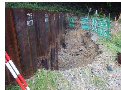
【ため池の崩落状況】
