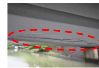
松田川橋 主桁のひび割れ
