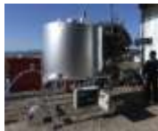
重油流出防止装置付タンク
