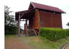
【土佐西南大規模公園 (四万十市)】 (公園施設の老朽化対策)
