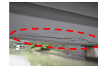
松田川橋 主桁のひび割れ
