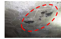
白髪隧道 覆工の剥離
