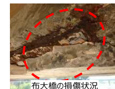
布大橋の損傷状況
