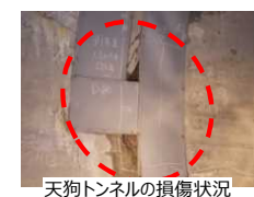
天狗トンネルの損傷状況
