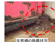
矢筈橋の損傷状況
